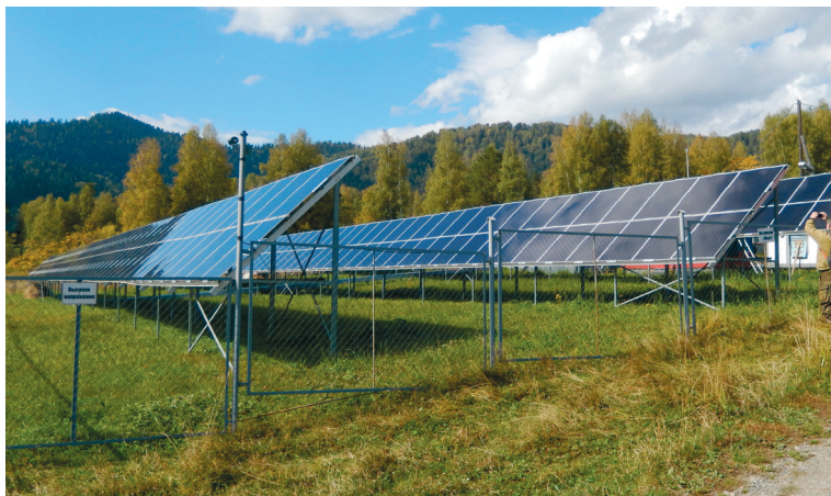
Рис. 10. Гибридная дизель-солнечная электростанция в селе Яйлю. Фото Т.А. Акимовой
